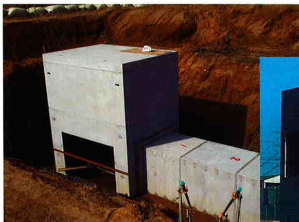
▲ BOXとの接続状況
