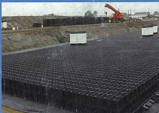
複合商業施設大規模貯留槽
